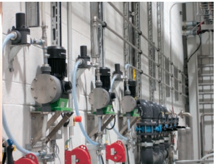
Pump- und Leitungssystem
